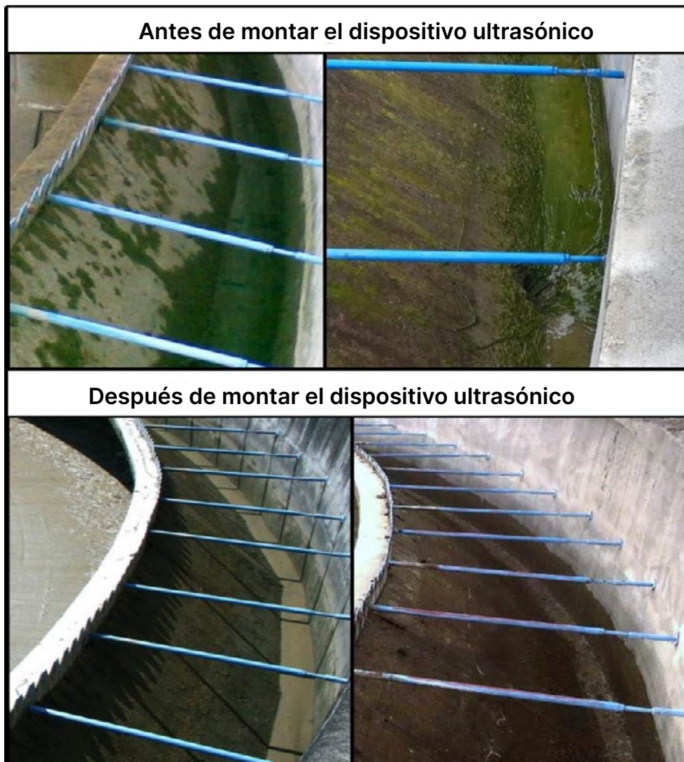
Figura 12- Canales colectores radiales cuando están parados para su lavado y desinfección
