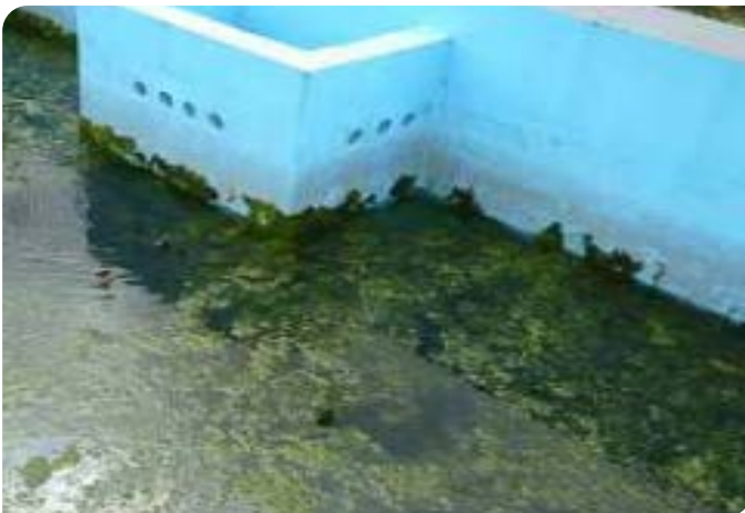
Figura 1: Antes do tratamento
